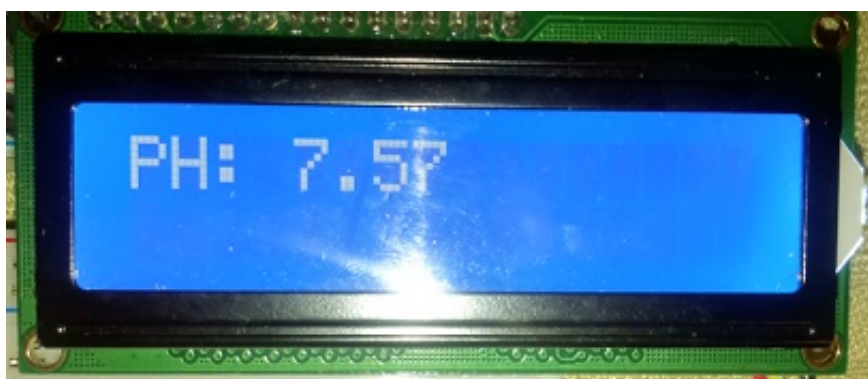
Ilustración 121: Pantalla LCD de la medida de PH del agua de la piscina climatizada.
