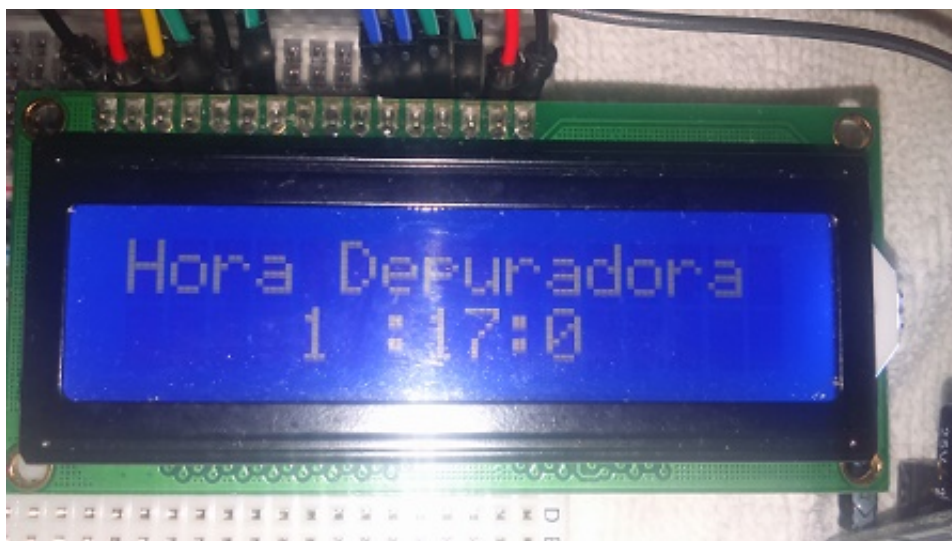
Ilustración 113: Pantalla LCD de la depuradora de la piscina climatizada.
