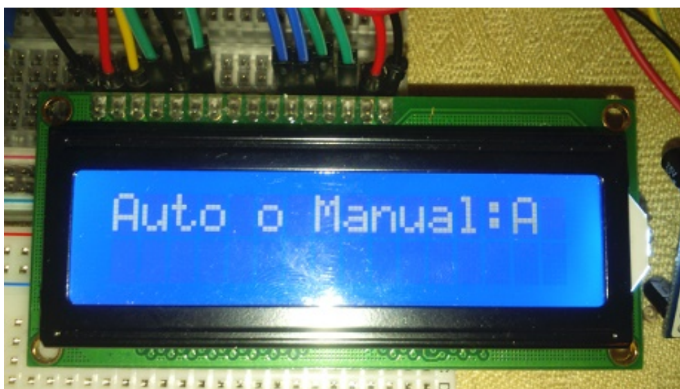
Ilustración 105: Pantalla LCD en el control de iluminación de la piscina climatizada.
